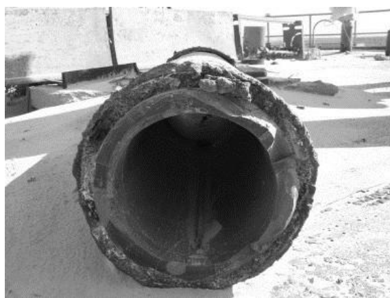
Рисунок. 2. Фотография трубы, футерованной каменным литьем
