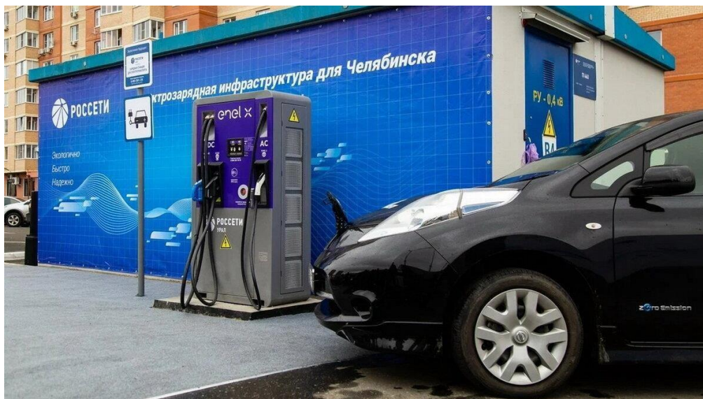
Рисунок 2 – Зарядная станция в г. Челябинск
