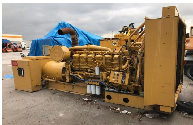
Рисунок 1. Дизельная генераторная установка Caterpillar
