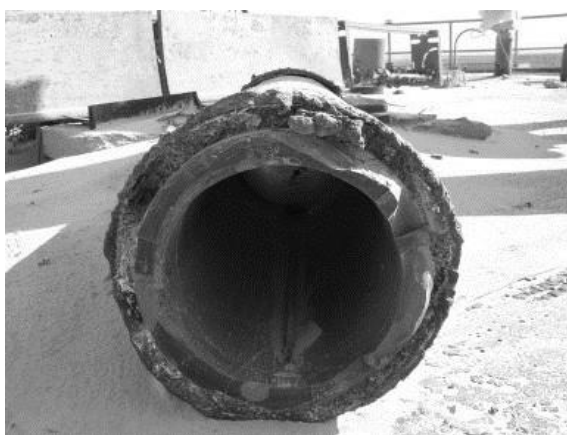
Рисунок. 2. Фотография трубы, футерованной каменным литьем
