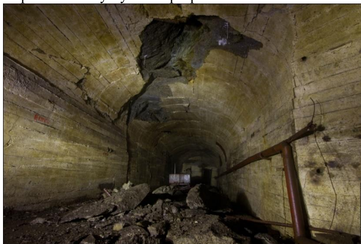
Рисунок 1 - Обрушение кровли в шахте по причине образовавшегося закола
