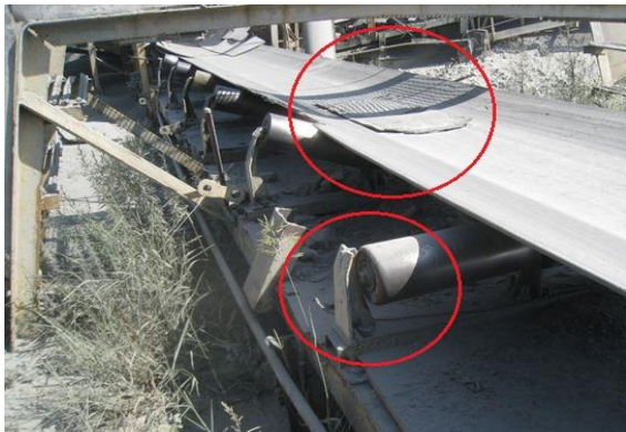
Ленточный конвейер (фабрика №1)
