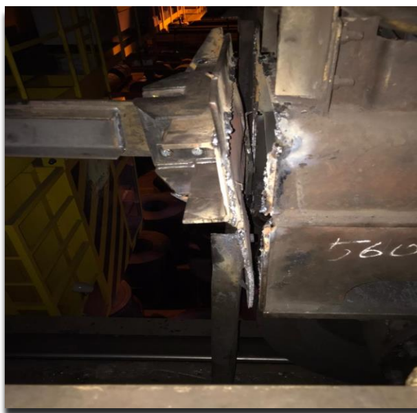
Рис. 2. Разрушение жесткой сцепки, её узлов крепления и элементов металлоконструкции концевых балок
