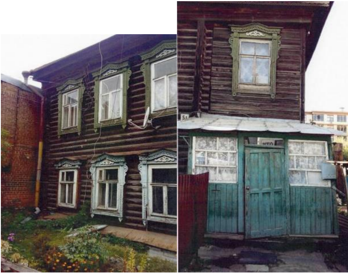
Рис.2. Фотографии фрагментов с характерными дефектами
