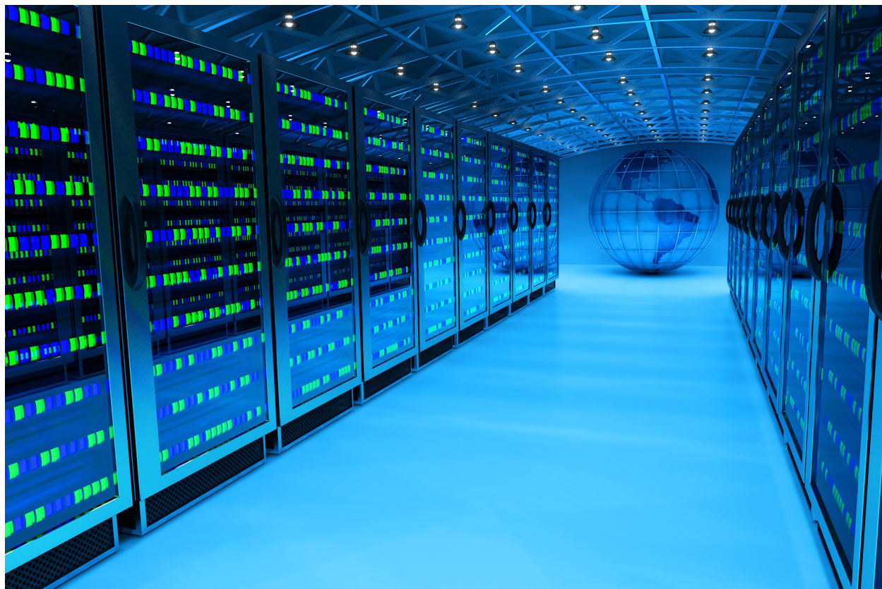
Рис. 7 – Центр хранения данных производства Titan Power [21]
