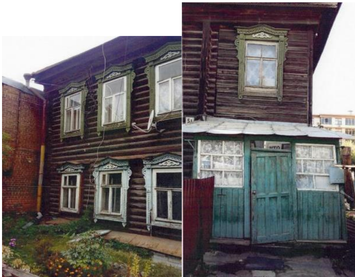
Рис.2. Фотографии фрагментов с характерными дефектами
